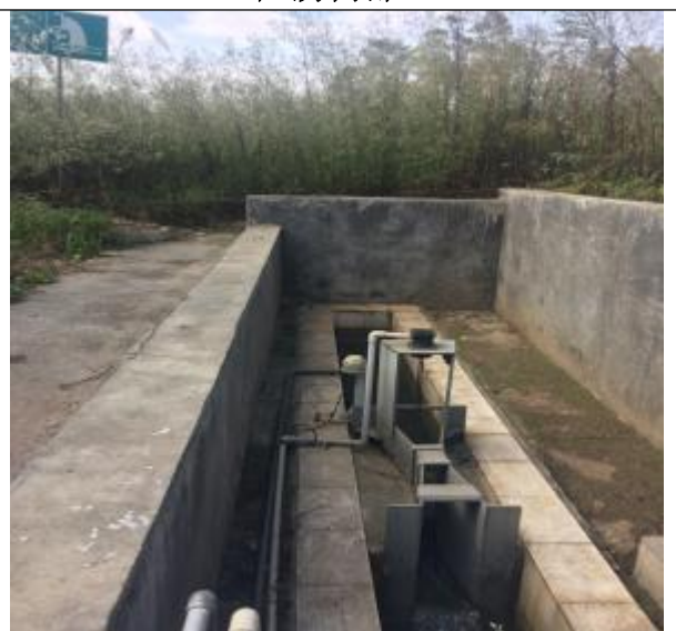
22#污水处理站出口
