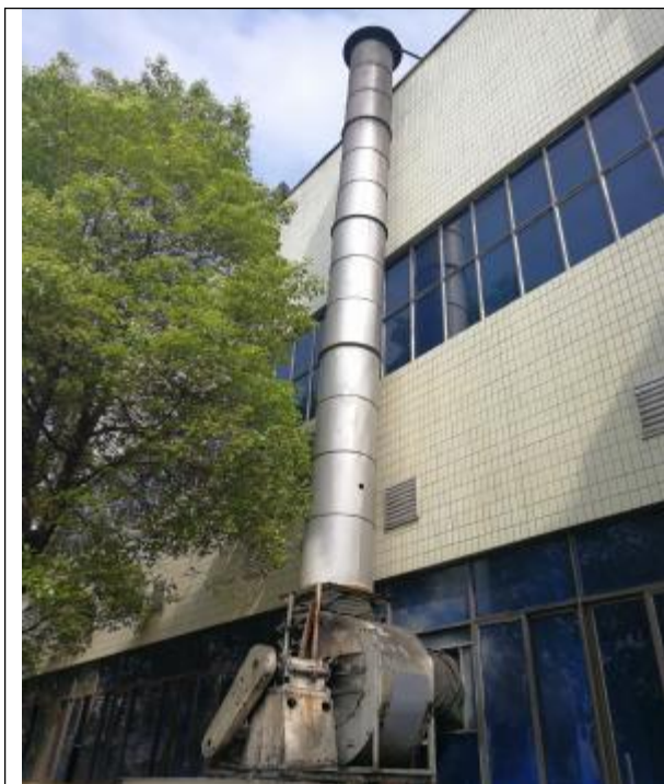
底漆房废气③ 排气筒
