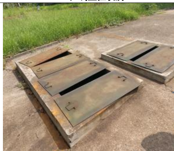
12#废水站隔油池
