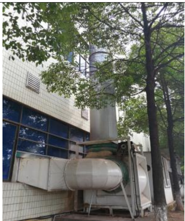
面漆房废气④ 排气筒
