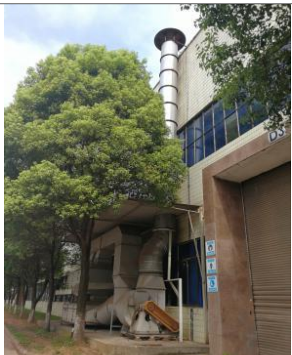
面漆房废气⑥ 排气筒
