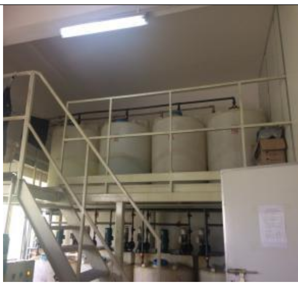
污水处理站加药储罐
