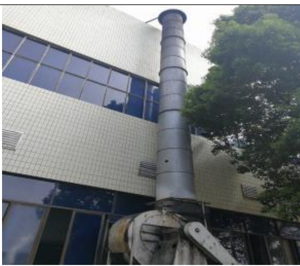
底漆房废气② 排气筒
