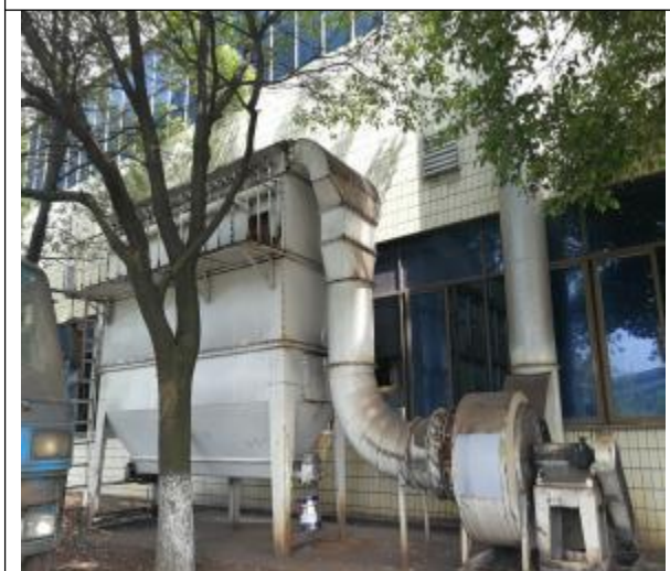
喷丸废气① 布袋除尘器及排气筒
