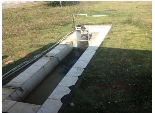
18#污水处理站出口
