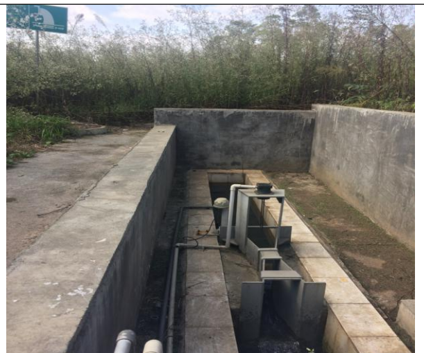
22#污水处理站出口
