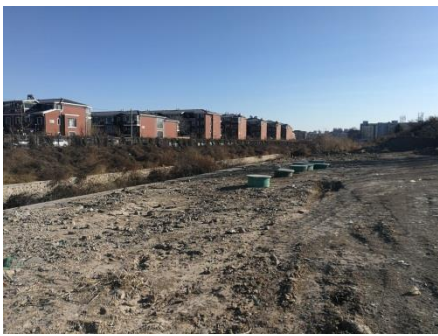
1、地埋式污水处理站
